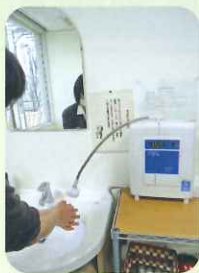
この度、電解次亜塩素酸水を自動的に生成する「クローライナー」を導入しました。手指の手洗い、消毒はもろろん、手すりや廊下の清掃、医療器具の洗浄、消毒、厨房機器の洗浄、殺菌など用途は多く、有効活用できると考えています。
